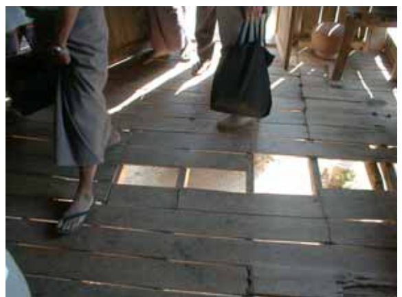
教室の床が抜けている
