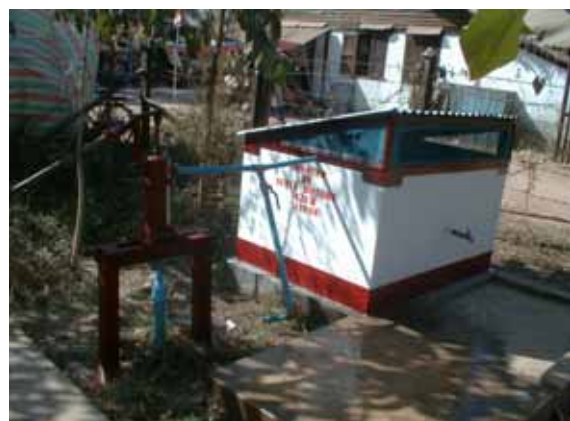
ポンプの横に屋根付きの貯水槽がある
